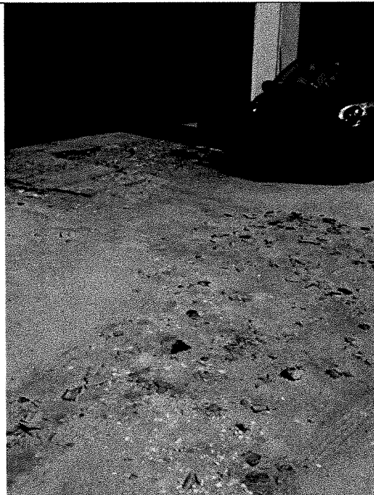
Inexistência de pavimento entre os prédios e o pavimento original em hexágonos de betão.
