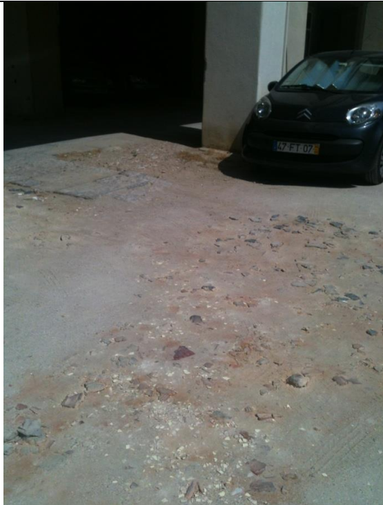
Inexistência de pavimento entre os prédios e o pavimento original em hexágonos de betão.
