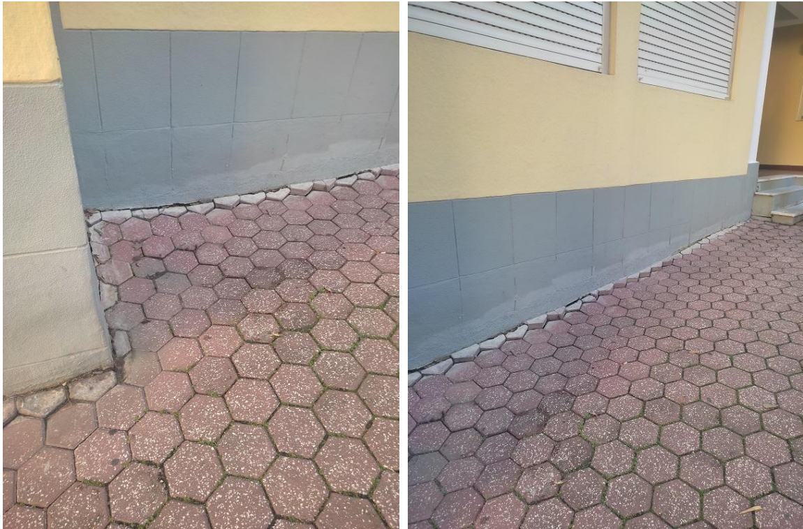
Fotografia 6 e 7 – Acesso no interior do bloco habitacional que necessita de intervenção.
