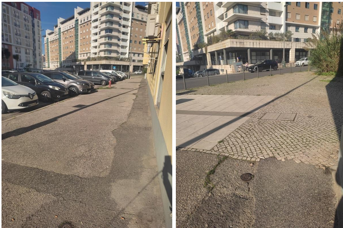
Fotografia 5 – Troço de passeio nas traseiras do Bloco C, na rua António Albino Machado.
