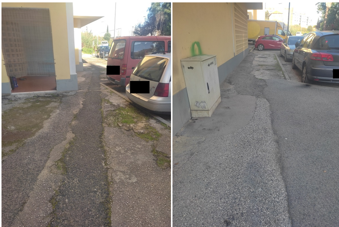
Fotografias 3 e 4 – Troço de passeio em frente ao Bloco C (Azinhaga dos Barros).
